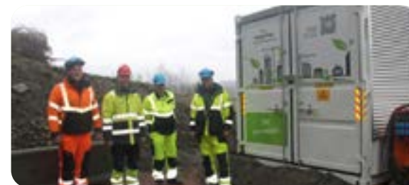
Grønt pilotprosjekt blir til ny omformerstasjon i Sande
