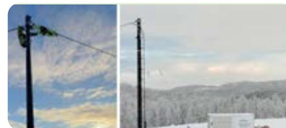
Provisorisk høyspentstasjon til NATO-øvelser på Camp Akkasæter
